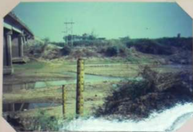
รูปถ่ายอาคารรับน้ำที่ สถานี ๒ (๕๐๐-๗๐๐) บริเวณใกล้เขื่อนทดน้ำ
