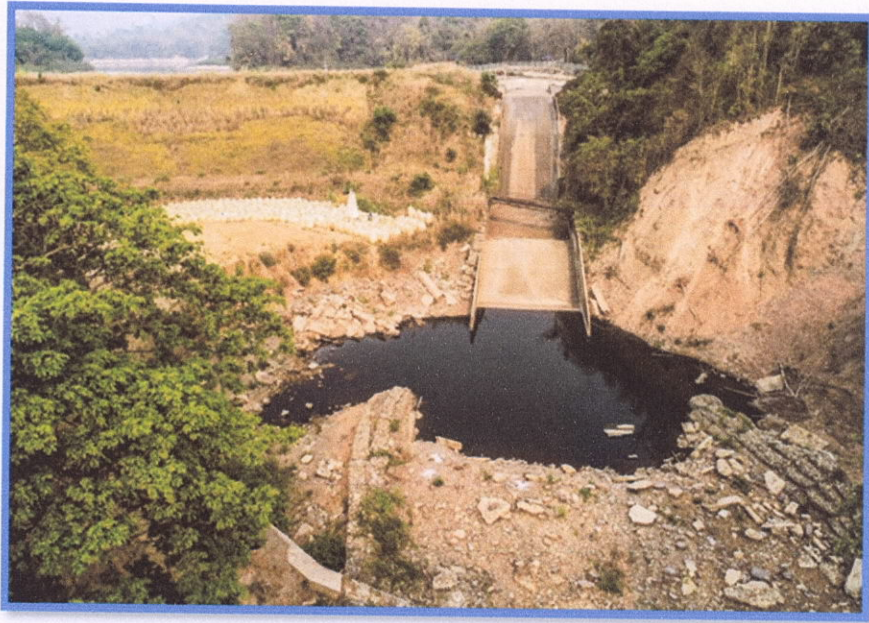
รูปที่ ๔ ความเสียหายบริเวณทำนบดินกับอาคารระบายน้ำล้น ปีพ.ศ. ๒๕๖๑
