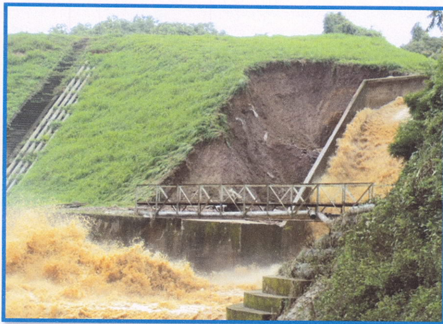
รูปที่ ๑ ความเสียหายบริเวณทำนบดินกับอาคารระบายน้ำล้น ปีพ.ศ. ๒๕๕๓
