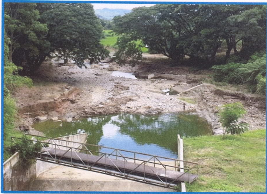
รูปที่ ๒ ความเสียหายบริเวณทำนบดินกับอาคารระบายน้ำล้น ปีพ.ศ. ๒๕๕๕
