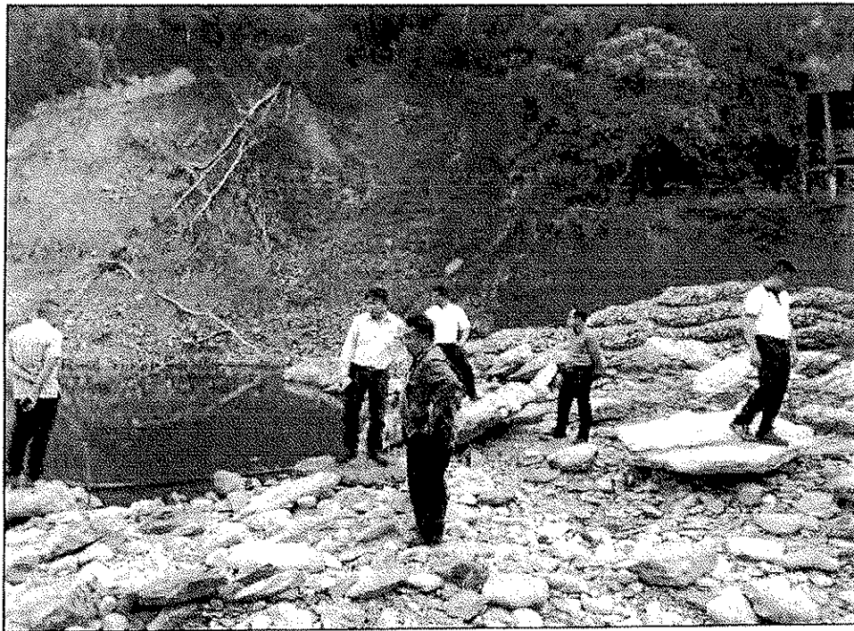
อาคารทางระบายน้ำล้นอ่างเก็บน้ำน้ำพอง อำเภอสันติสุข จังหวัดน่าน ที่ถูกน้ำกัดเซาะบริเวณด้านท้ายน้ำพังเสียหาย
