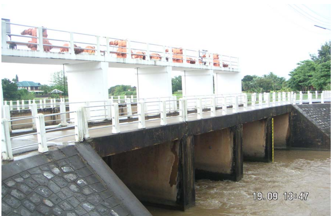
รูปที่ 3 แสดงประตูละบายน้ำคลองสายใหญ่
